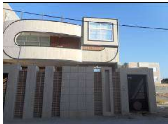
شکل ۸- عدم تطابق نحوه کاربرد مصالح در نمای بیرونی بنا با اقلیم در مسکن جدید منطقه مورد مطالعه (خیابان فدائیان اسلام)
